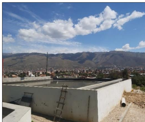
Figura 2. Tanque de homogenización de la PTAR de Sacaba
